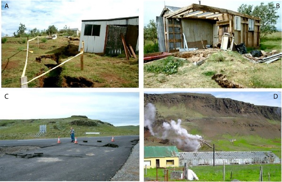
Figure I.18. Destructions lors des séismes de juin 2000 à Bitra (© Françoise Bergerat) : A, B) bâtiments de la ferme, C) route n° 1) ; et de mai 2008 à Hveragerði (© Brigitte Van Vliet-Lanoë) : D) canalisations disloquées et serres endommagées
